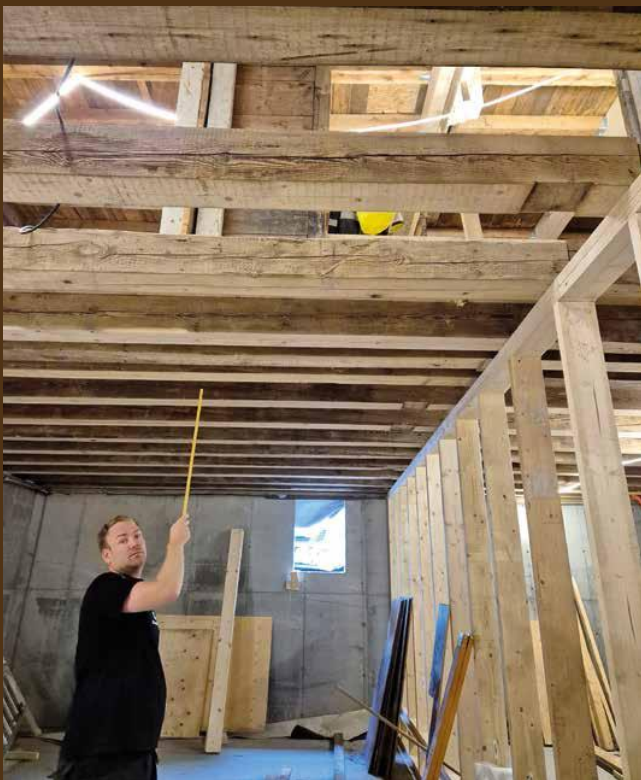
Anleggsleder Kim-Alexander Nilsen fra Klimabygg viser takhøyden i kjelleretasjen. Bjelkelagskonstruksjonen til 1. etasje består av gjenbruksvirke fra Toftegaard Trelast (det gamle TV2-bygget).
