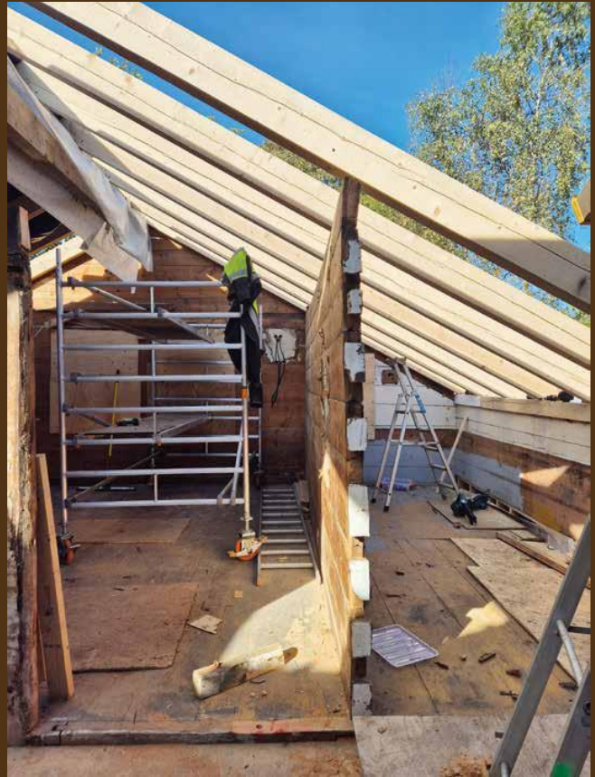
Den gamle takkonstruksjonen var i så dårlig stand at alt måtte rives og måtte bygges ny med sperr fra samme tidsepoke. De opprinnelige hanebjelkene er erstattet med taksperr som hviler på mønre-drager. Det øker innvendig takhøyde.
