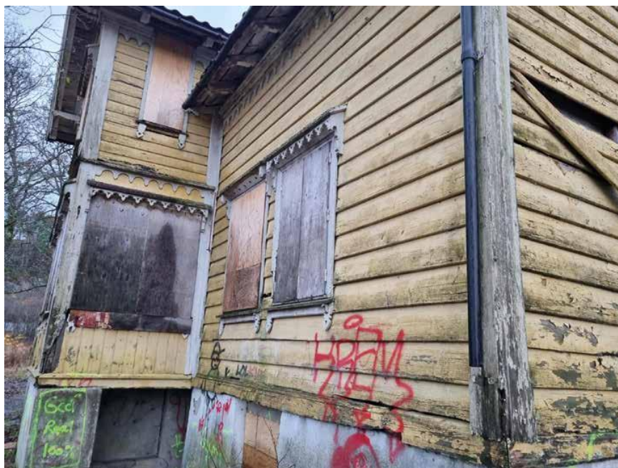
Klimabygg tettet huset før restaurering. Det hadde blitt ei nedslitt rønne, brukt av bydelens løse fugler.
